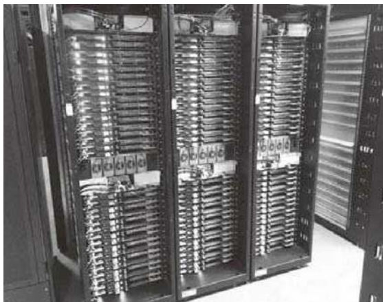
② • 基于Open Vault Storage解决方案的Cold Storage机架
