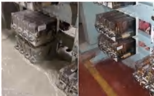
被混凝土淹了的伦敦地铁维多利亚线的控制室(左)和被淹之前(右)
