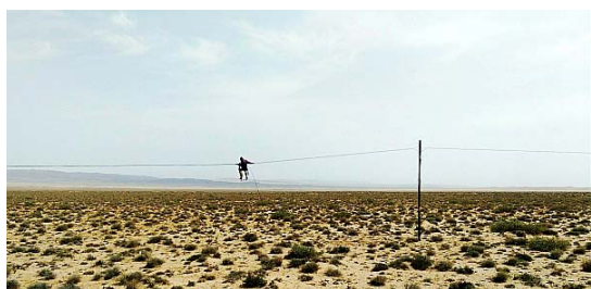
1 荒漠里的架线工 作者:秋雨 拍摄设备:努比亚 Z9 原来电线是这么架的啊
