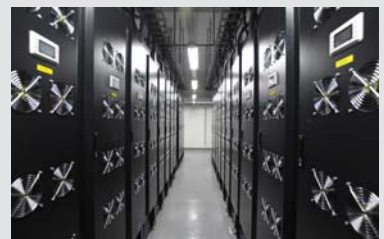
富士康贵州大数据中心内部
