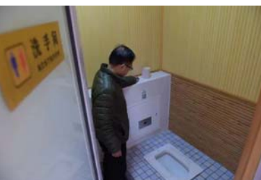
岳良村村民正在使用改造完成的“真空厕所”
