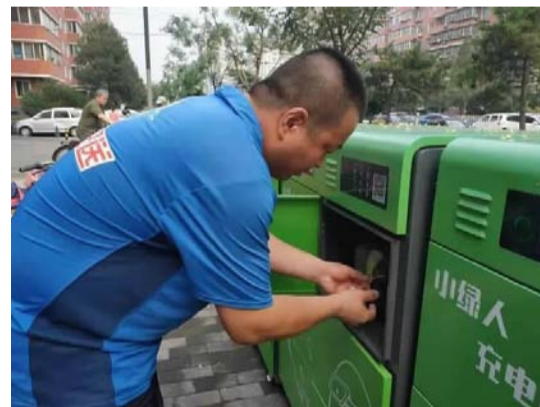
电动车充电桩
