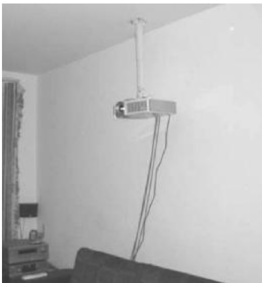
安装完成前需要先连线测试
