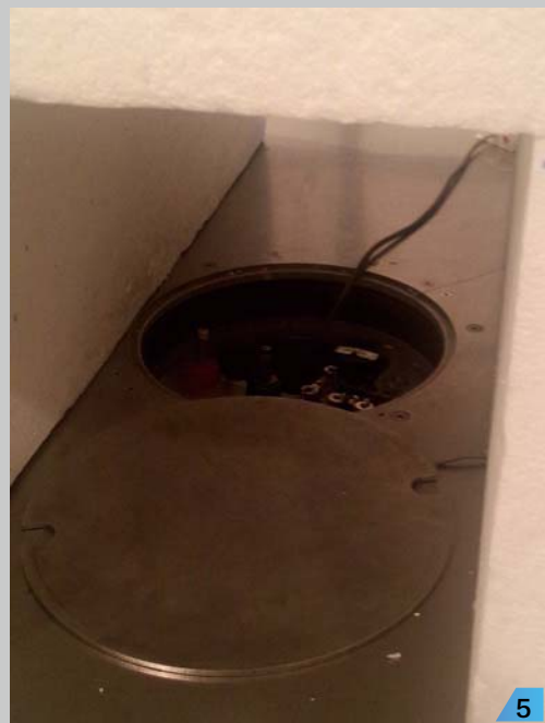
■ 电波暗室的供电源也需要做充分的屏蔽处理。
