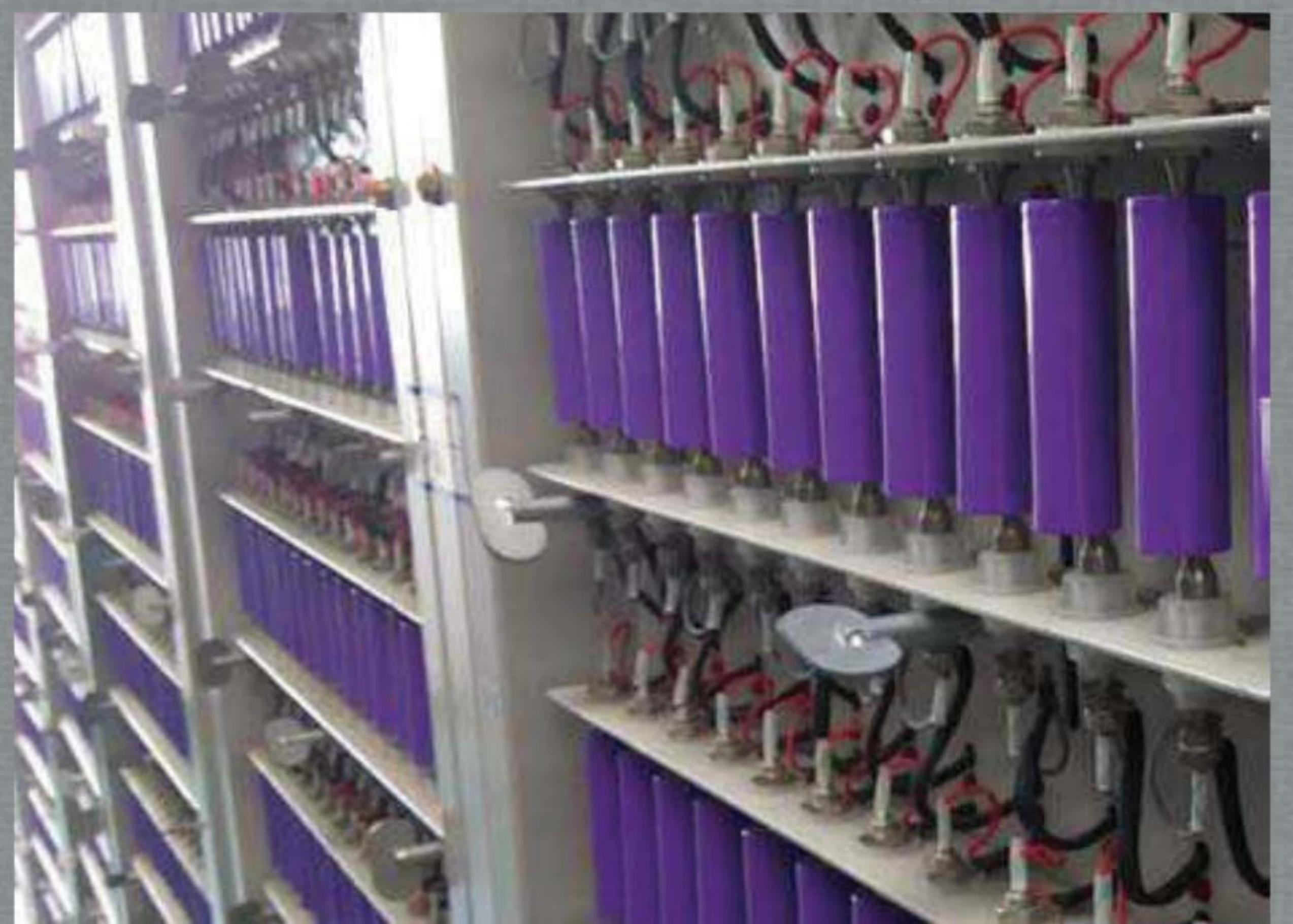
■ 化成工艺:采用分容柜完成首次充电。
