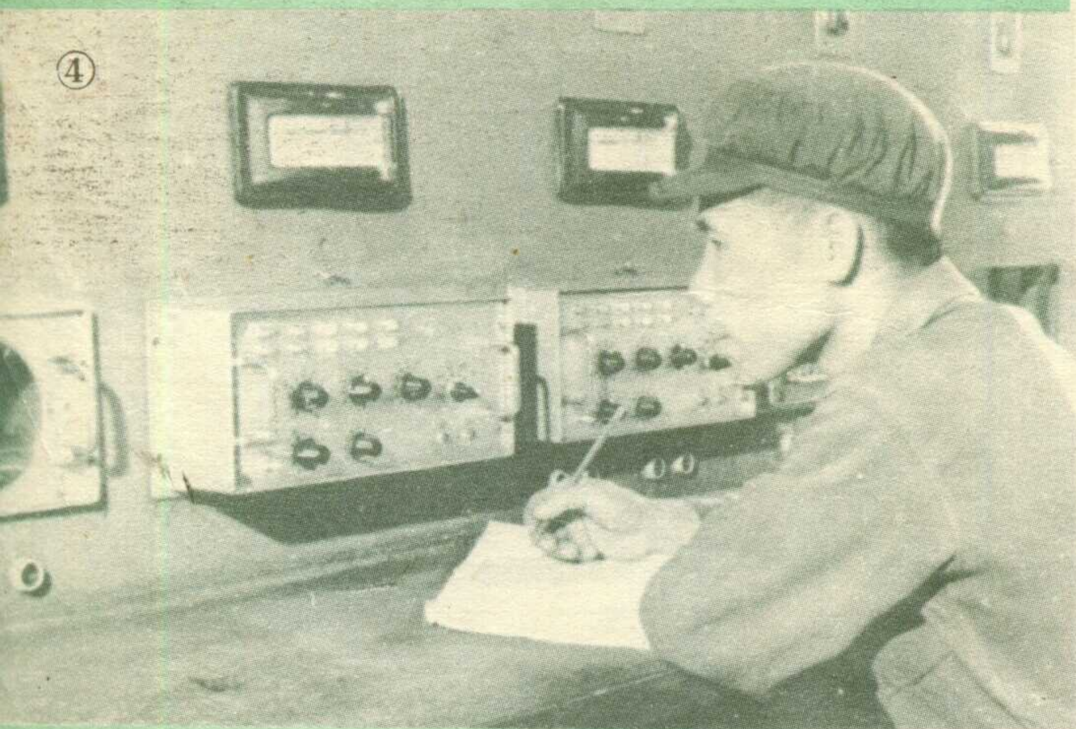
4. 高要县县办化肥厂采用简易煤气发生炉自动控制仪后，工人们可以离开炉前操作，在控制室监测机器的运转情况。
